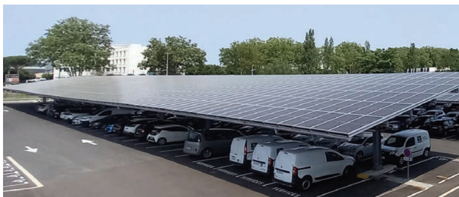
Les ombrières du Campus Macif à Niort permettent de couvrir 15 % de ses besoins énergétiques
